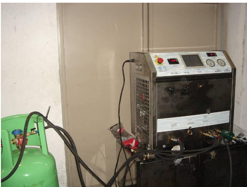
Conexión para limpieza Fri 3 Oil System al circuito de la enfriadora.
